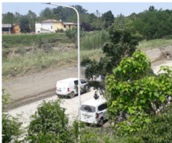
Il muro di via Cimatti dove da anni si registravano perdite
